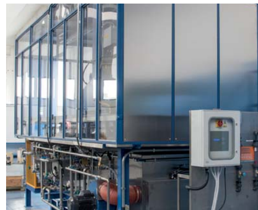
Il nuovo impianto di lavaggio in continuo
